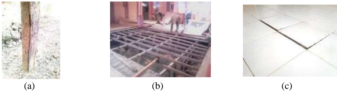
Gambar 5. Kondisi Tiang Kayu
