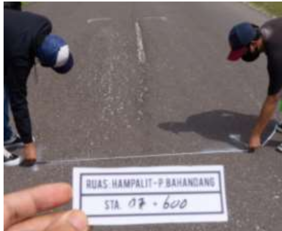
Gambar 4.1 Kerusakan Retak Buaya
