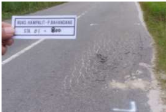
Gambar 4.4 Kerusakan Retak Selip
