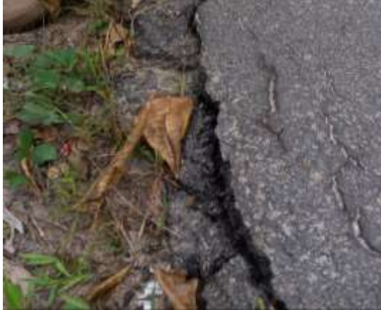
Gambar 4.3 Kerusakan Retak Pinggir
