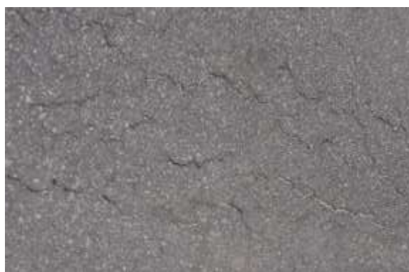
Gambar 4.2 Kerusakan Retak Halus
