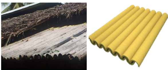
Gambar 22. Bambu sebagai Material Penutup Atap Rumah Balai dan Sistem Pemasangannya Sumber: Arsip Penulis, 2006
