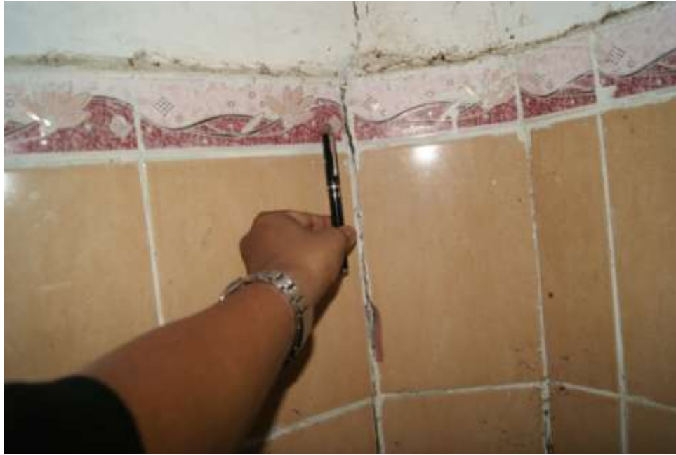
Gambar 4. Retak settlement di lantai dasar sisi kiri sebesar > 5 mm
