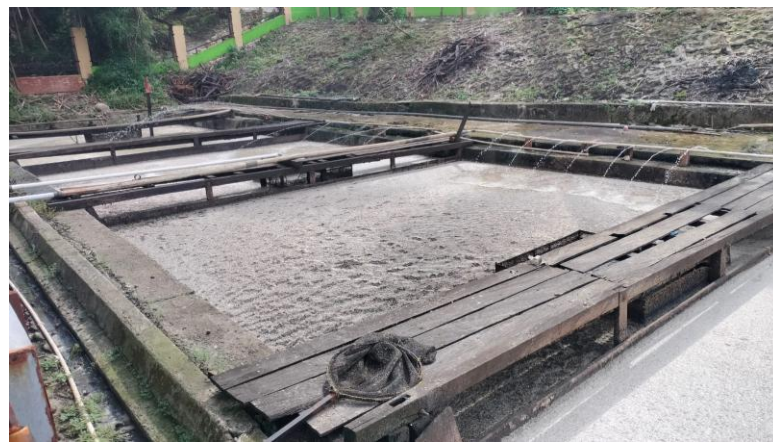
Gambar 3. Unit Aerasi Pengolahan Air Limbah Industri Tahu dan Tempe pada Sentra Industri Kecil Sumber (SIKS) di Balikpapan
