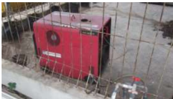
Gambar 6. Genset di TPA Cahaya Kencana
