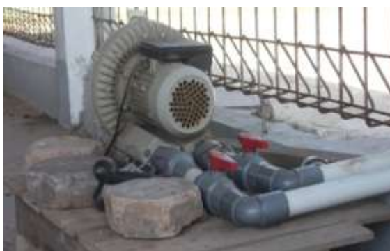
Gambar 5. Blower biogas di TPA
