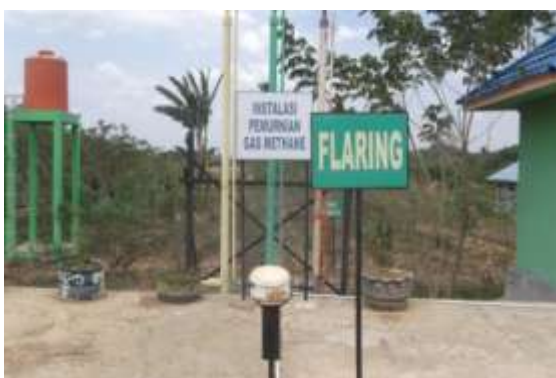
Gambar 4. Instalasi pemurnian di TPA Cahaya Kencana
