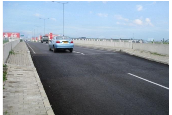
Gambar 7. Kerusakan oprit jembatan
