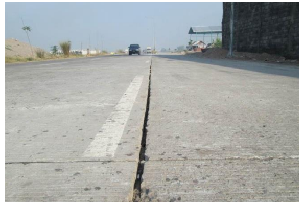
Gambar 6. Kerusakan jalan perkerasan kaku
