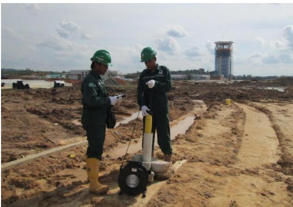
Gambar 92. Monitoring instrumen geoteknik
