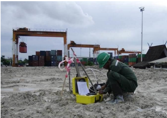
Gambar 84. Monitoring instrumen geoteknik
