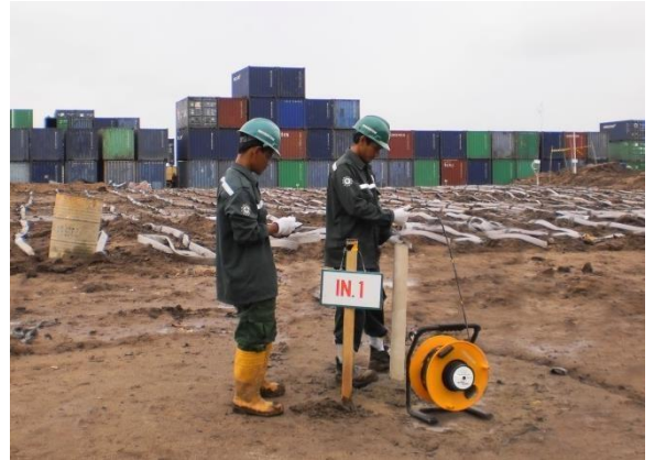
Gambar 80. Monitoring instrumen geoteknik
