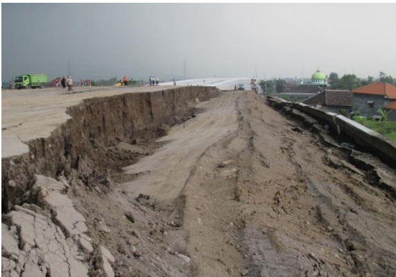
Gambar 4. Kerusakan timbunan badan jalan
