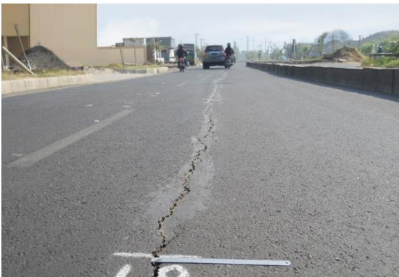
Gambar 5. Kerusakan jalan perkerasan lentur
