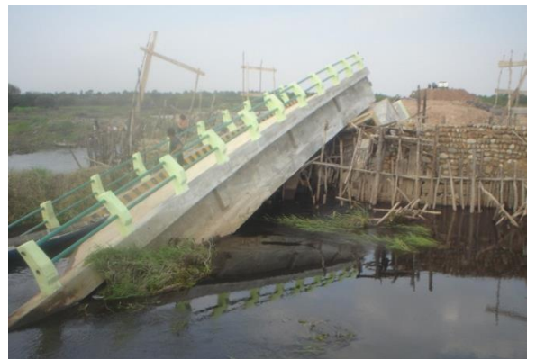
Gambar 8. Kerusakan konstruksi jembatan
