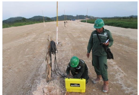
Gambar 95. Monitoring instrumen geoteknik
