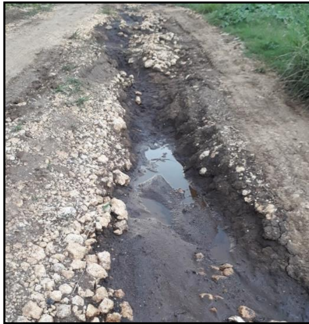
Gambar 1. Erosi Parit pada Lokasi Pengamatan Sumber: Dokumentasi Tim Peneliti, 2022
