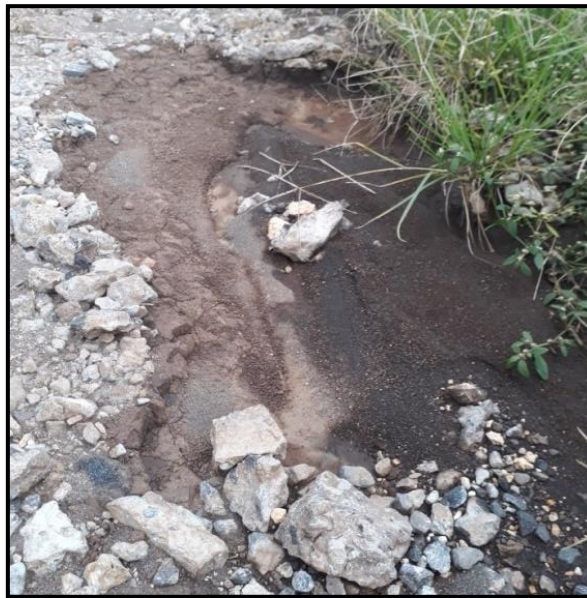
Gambar 4. Erosi Lembar pada Lokasi Pengamatan Sumber: Dokumentasi Tim Peneliti, 2022
