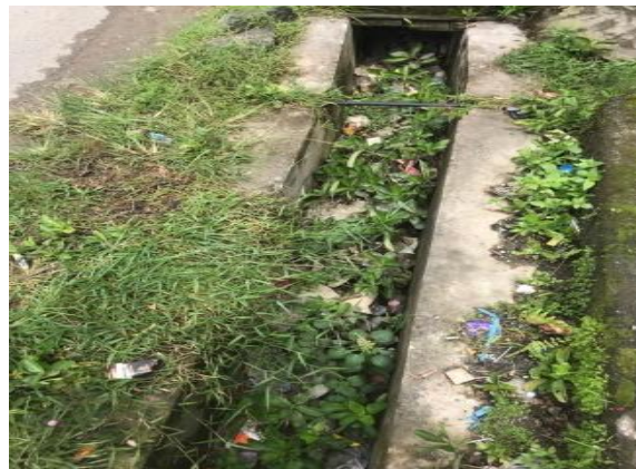
Gambar 3. 1 Kondisi Eksisting Saluran Drainase
