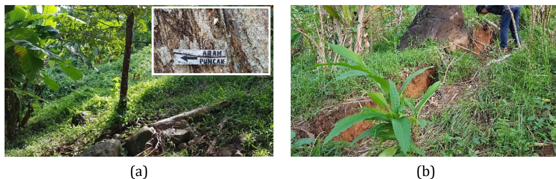
Gambar 2. Akses menuju bukit Tamiyang (a) dan retak sebagai potensi longsor di sekitar lereng (b)
