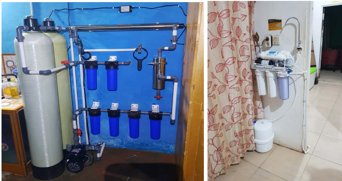
Gambar 3. Peralatan filtrasi air yang telah terpasang
