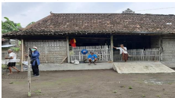
Gambar 2. Rumah Tidak Layak Huni
