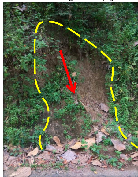
Gambar 6. Longsor di tepi jalan
