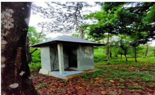
Gambar 3. Toilet yang ada di HKP
